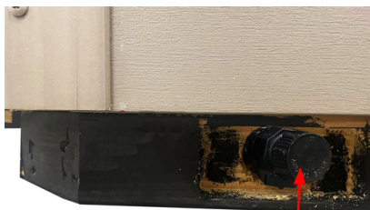
Tapa de desagüe
